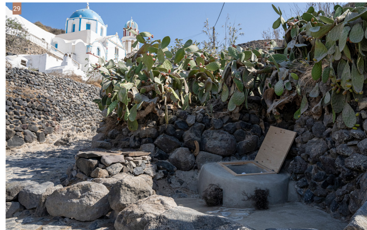
Εικ. 29| Αποψη της στέρνας Α σε σχέση με το κεντρικό μονοπάτι μετά τις εργασίες αποκατάστασης. (Φωτ: Γ. Κυβερνήτης)
